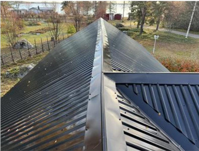
Taknocken är inte rakt monterad.
