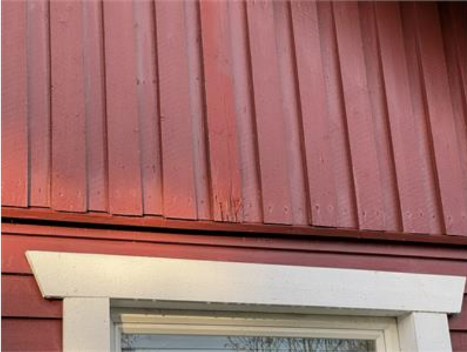
Lokal rötskada i fasadpanel.
