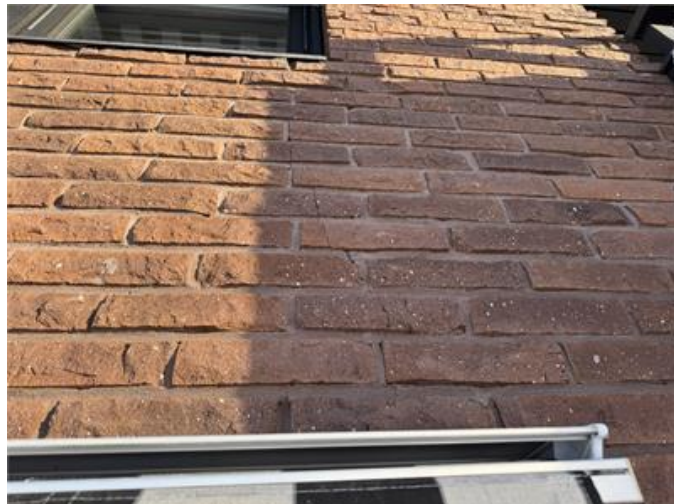
Spricka i tegelfasaden.
