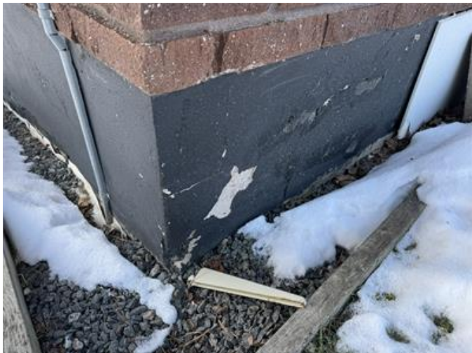
Sprickor och färgsläpp på sockel.
