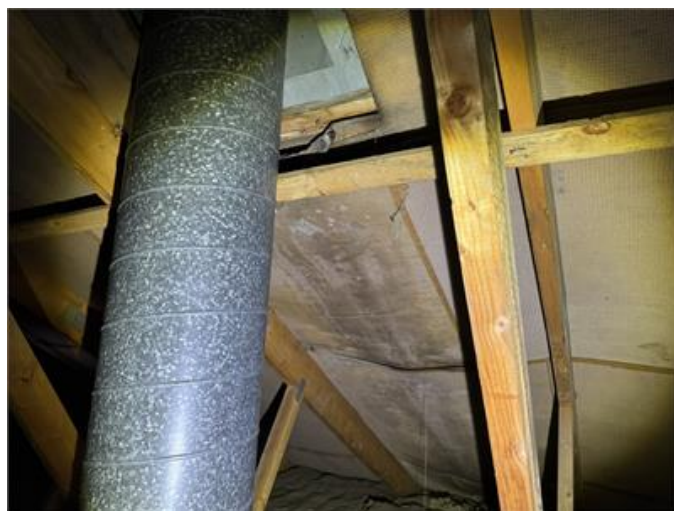
Fuktfläckar på underlagstak av board i vindsutrymme.
