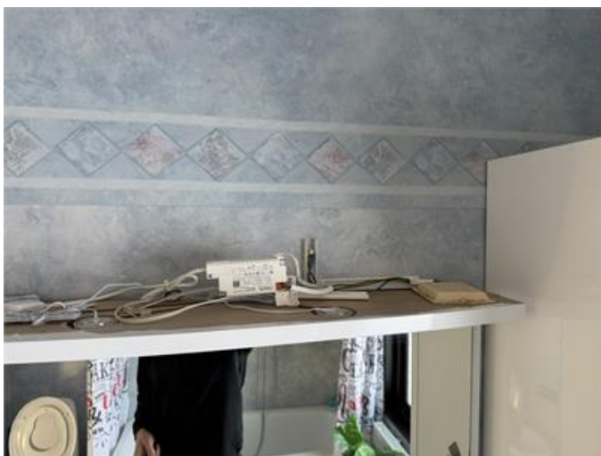
Bristfälligt utförda elinstallationer till badrumsspegel.
