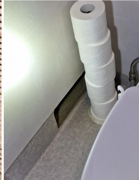
Bild 8. Hål i sockel till garderob.
