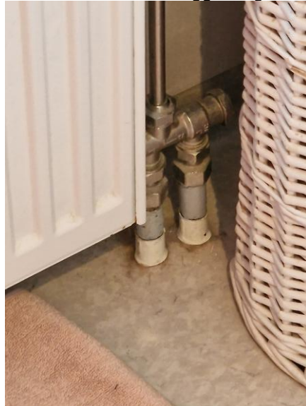
Bild 7. Rör genomföring i golv.
