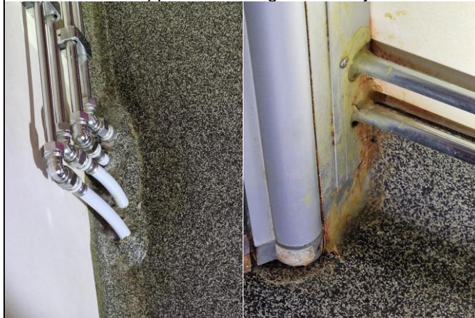
Bild 12. Rör genomföring i golv Bild 13 Smuts/avlagring mot väggskena.
