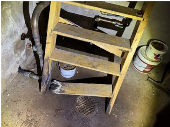
Fuktskador på trappa i jordkällare.
