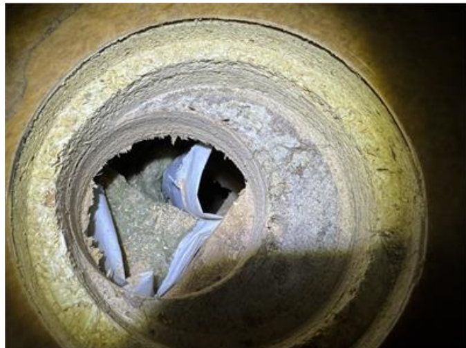
Bristfällig isolering i golvbjälklag vid provhål för konstruktionskontroll.
