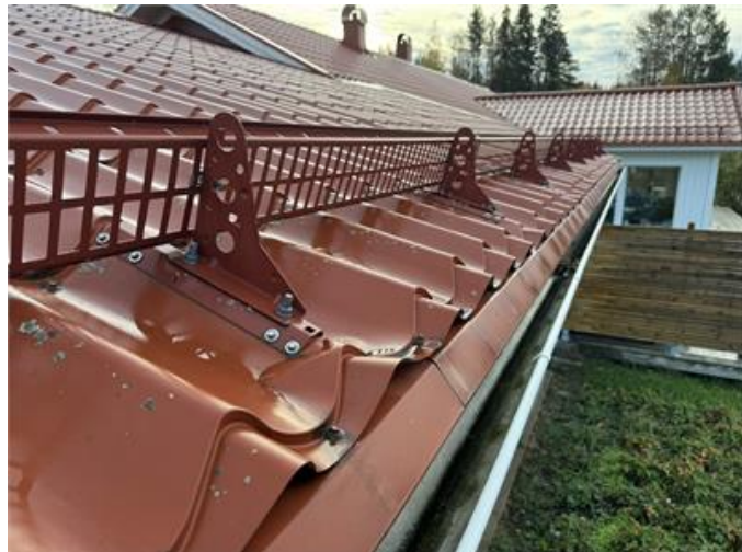
Tryckskador på takplåt vid snörasskydd.
