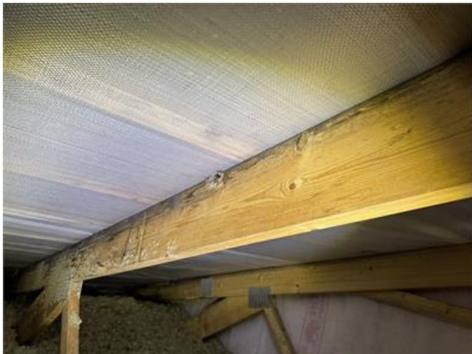
Missfärgning/fuktbläckar på takstolar i vindsutrymme.
