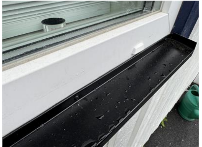
Felkonstruerat plåtbleck på fönster.
