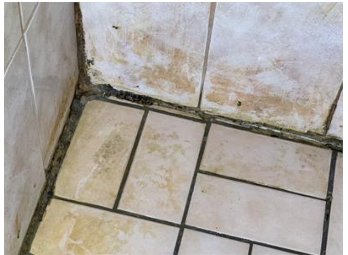
Bristfällig silikonfog i dusch/bastu.
