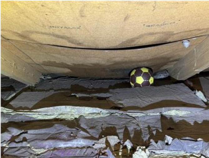
Fuktfleck på underlagstak i vindsutrymme över ekonomidel/garage.
