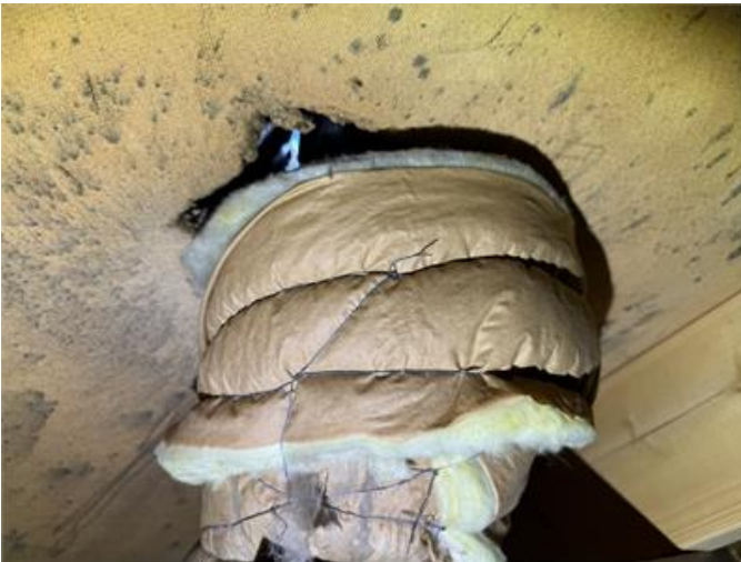
Mindre otätheter vid rör genomföring i taket.
