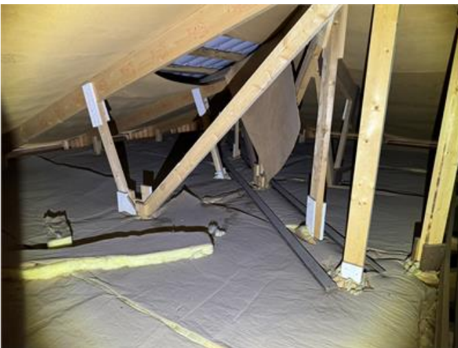
Kondensskydd/underlagstak av masonitskivor har lokalt lossnat.
