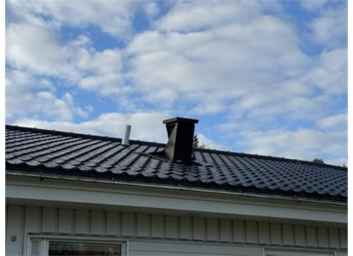
Tryckskador på takhuv. Vid genomföring av det vita röret ovanför observerades mindre läckage/otätheter från vindsutrymmet.
