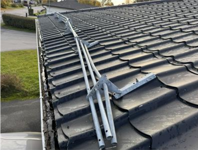
Skador på snörrasskydd och takplåt.
